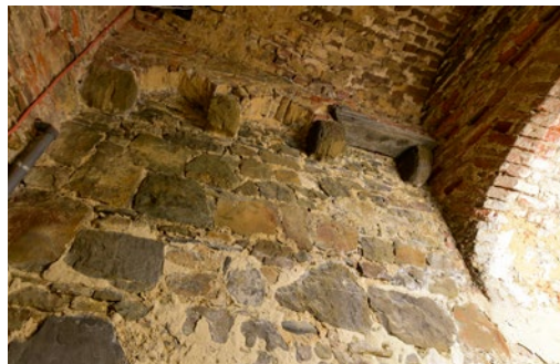
Muur van één van de kelders onder het stadhuis. Mogelijk stond het in de dertiende en veertiende eeuw genoemde gewandhuis op de plaats van het huidige stadhuis en is deze kelder daar het fysieke overblijfsel van.
